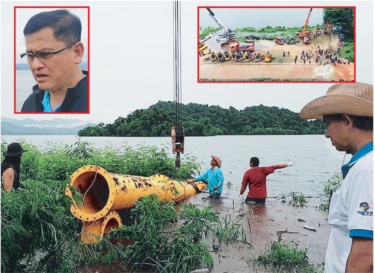
▲ รับมือน้ำ เจ้าหน้าที่ติดตั้งเครื่องสูบน้ำ บริเวณเขื่อนแก่งกระจาน จ.เพชรบุรี เพื่อเตรียมระบายน้ำหลังเข้าใกล้จุดวิกฤติ ขณะที่นายสมเกียรติ ประจำวงษ์ เลขาธิการ สทนช. (ภาพซ้าย) ลงพื้นที่ติดตามสถานการณ์อย่างใกล้ชิด (ภาพขวา) เคนยกและวางท่อเหล็กระบายน้ำก่อนล้นสปิลเวย์.
