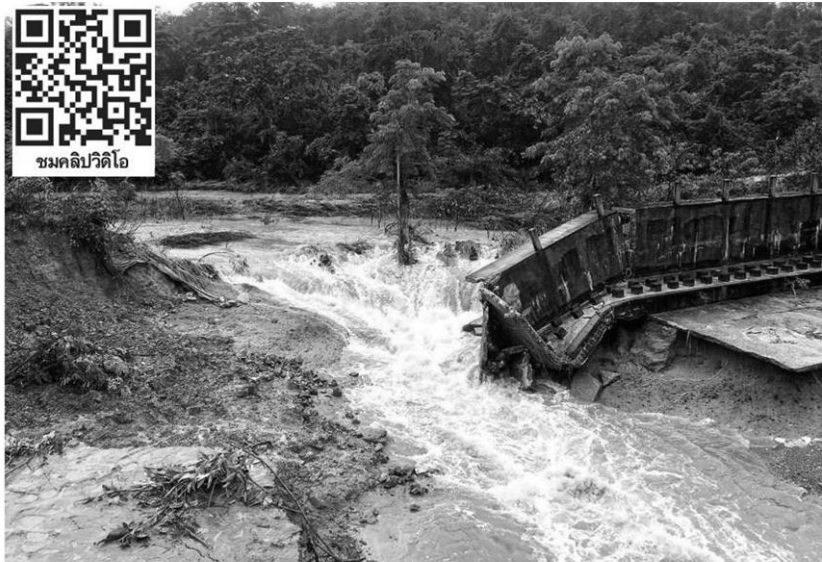
อ่างแตก - สภาพอ่างเก็บน้ำหินตะไองชำรุดพังเสียหายฝ่ายทุก น้ำในอ่างปริมาณกว่า 1.2 ล้านลูกบาศก์เมตรไหลทะลักเข้าท่วมบ้านลำประโคนเหนือ หมู่ 5 และบ้านลำประโคน หมู่ 3 ได้รับความเสียหายกว่า 60 หลังคาเรือนที่ จ.นครราชสีมา เมื่อวันที่ 18 ตุลาคม
