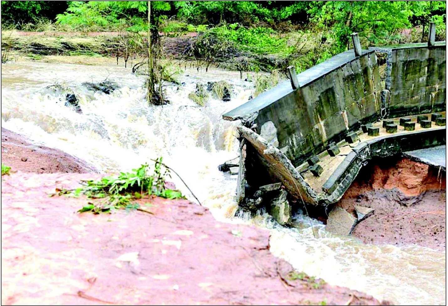
อ่างเก็บน้ำหินตะไคง ต.สำนางแก้ว อ.ปักธงชัย จ.นครราชสีมา หลังรับน้ำฝนมาหลายวันทำให้ฝายกั้นน้ำพังเสียหาย น้ำไหลป่าเข้าท่วมบ้านเรือน ชนวนาหน้าเข็ดถนนชาด
