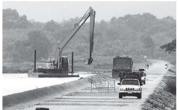
สปีดเวย์บริเวณเขื่อนปัตตานี จะมีการเสริมเส้นทางระบายน้ำให้สูงขึ้น 30 ซม. ส่งผลให้ระบายน้ำได้รวดเร็วยิ่งขึ้น.
