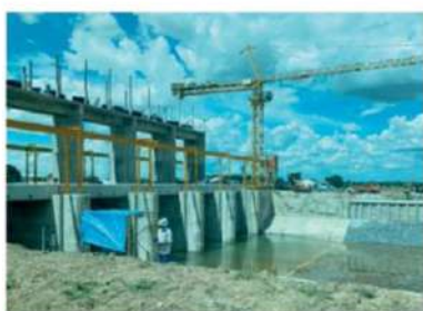
(ก่อสร้าง ปตร.พระปตทิษฐ์ (แทนของเดิม)) รูปายงานที่ปรับปรุง/ก่อสร้างใหม่แบบงานที่ 1
