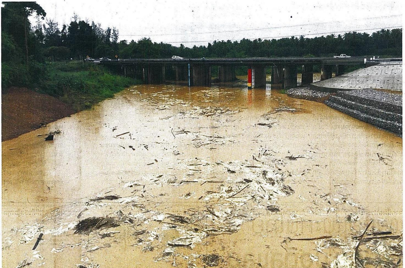
ท่วมสูง : หลังฝนตกต่อเนื่อง น้ำป่าได้ทะลักเข้าสู่คลองสาธารณะและกระแสน้ำไหลกัดเซาะคอสะพาน บนถนนเพชรเกษม บริเวณ ต.อ่างทอง อ.ทับสะแก จ.ประจวบคีรีขันธ์ เจ้าหน้าที่ ต้องอำนวยความสะดวกและเตือนให้ประชาชนใช้ความระมัดระวัง
