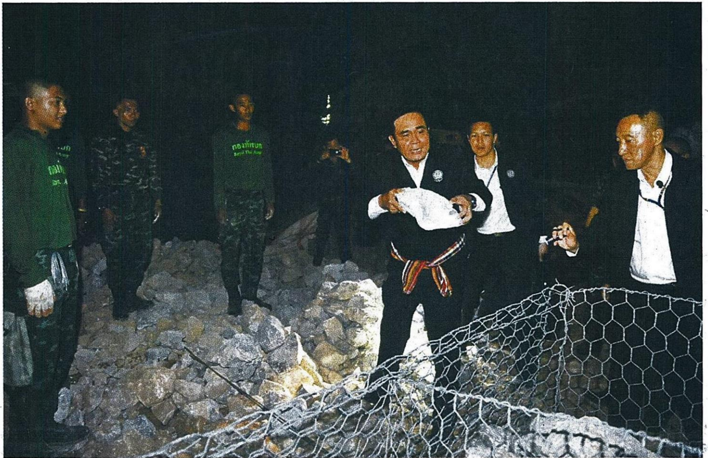
ซ่อมพนัง : พล.อ.ประยุทธ์ จันทร์โอชา นายกรัฐมนตรี ตรวจสอบให้กำลังใจผู้ปฏิบัติงานซ่อมพนังคันดิน คลองชลประทาน โครงการส่งน้ำและบำรุงรักษาหนองหวาย บ้านคุยโพธิ์ ต.บึงเนียม อ.เมืองขอนแก่น ที่ได้รับความเสียหายจากความรุนแรงของกระแสน้ำ จากลำน้ำพอง เมื่อวันที่ 28 ต.ค.ที่ผ่านมา
