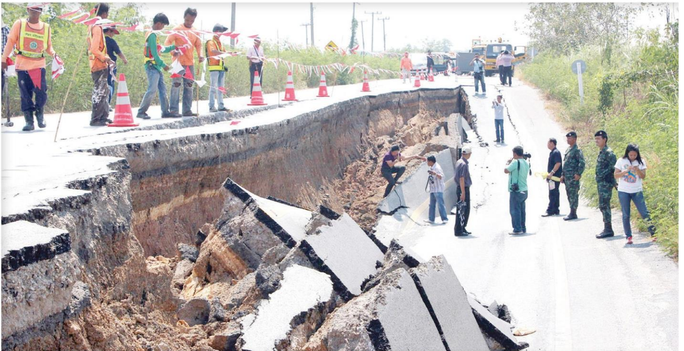
▲ ฤทธิแล้ง...ถนนเลียบบคลอง 13 ัญบุรี-ลำลูกกา ช่วง กม.0+700 ฝั่งตะวันออก หมู่ 5 ต.บึงนาราง อ.ัญบุรี จ.ปทุมธานี ซึ่งเป็นถนนแอสฟัลต์ กว้าง 10 เมตร ทรุดตัวเป็น ทางยาวกว่า 100 เมตร ลึก 4 เมตร และมีรอยแตกกว้างยาวกินระยะทางอีกกว่า 500 เมตร ส่อแววจะทรุดตัวเพิ่มขึ้นสาเหตุมาจากภัยแล้งที่ส่งผลให้น้ำในคลองลดลงจนเกือบแห้งขอด
