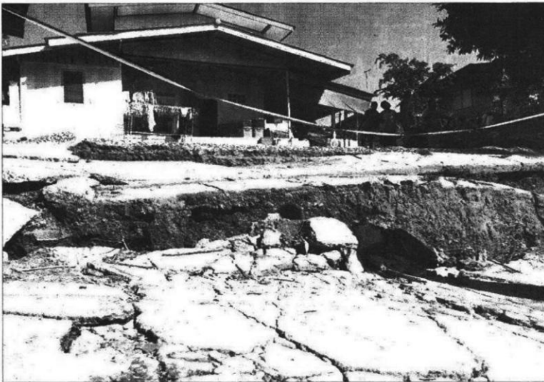
▲ แล้งจัด : สภาพพื้นดินริมแม่น้ำป่าสักเกิดการทรุดตัวส่งผลให้บ้านของประชาชนที่อยู่บริเวณริมแม่น้ำในพื้นที่ ต.ท่าหลวง อ.ท่าเรือ จ.พระนครศรีอยุธยา ได้รับความเสียหาย ซึ่งเป็นผลกระทบจากภาวะภัยแล้งน้ำ ในแม่น้ำป่าสักลดต่ำสุดในรอบหลายสิบปี
